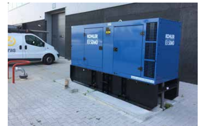
Foto: Noodstroomaggregaat van SDMO.
